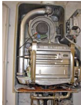
Eine Einbindung des Gerätes in eine offene Schwerkraft-Warmwasserheizung ist über eine hydraulische Weiche möglich. Anfang der 90er-Jahre gab es dazu Umstellungsempfehlungen der Hersteller
