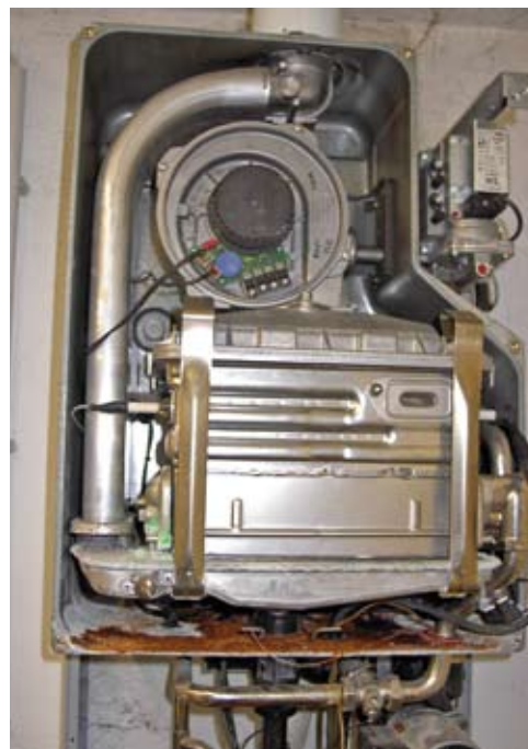
Da staunte nicht nur der Kundendienstmonteur: Dieser Vaillant-Durchlauferhitzer war in eine offene Schwerkraftanlage eingebunden
