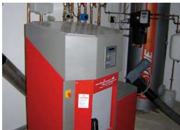
Neben den Solaranlagen installiert Schmidt auch viele Stückholz- und Pelletsheizungen. Sehr beliebt ist die Kombination Solar/Holz
