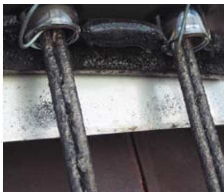
Bild 6 Kupferverrohrung eines Vakuumröhrenkollektors mit starker Verzunderung nach ca. einem Jahr Einsatz
