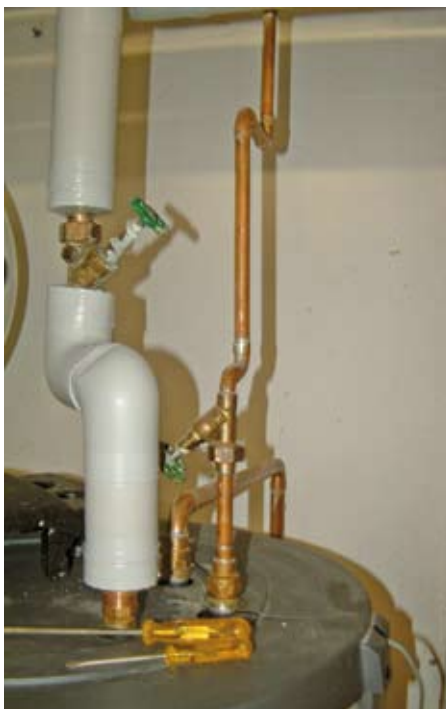
Installationsfehler: Der Kollektorkreis ist nicht wärmegeämmt und die Leitungen zum Speicher sind es nur teilweise
