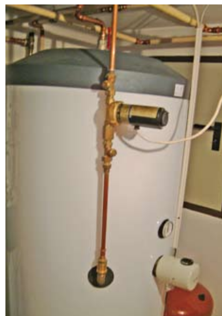
Installationsfehler: Der Warmwasserabgang am Speicher sowie die Zirkulationsleitung oben sind nicht wärmegeklämt
