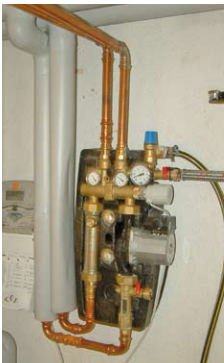
Installationsfehler: Die Zirkulationsleitung ist ungedämmt und die Zirkulationspumpe befindet sich im Dauerbetrieb
