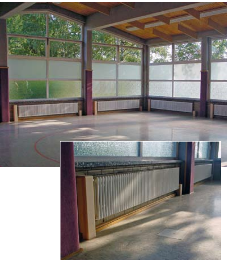
Sechs 58-gliedrige Delta-Röhrenradiatoren von Purmo beheizen die Gymnastikhalle der Förderschule. Wegen der Unfallgefahr verlaufen die Heizungsrohre unter dem Schwingboden
