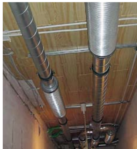
Die Schalldämpfer können in den abgehängten Flurdecken untergebracht werden
