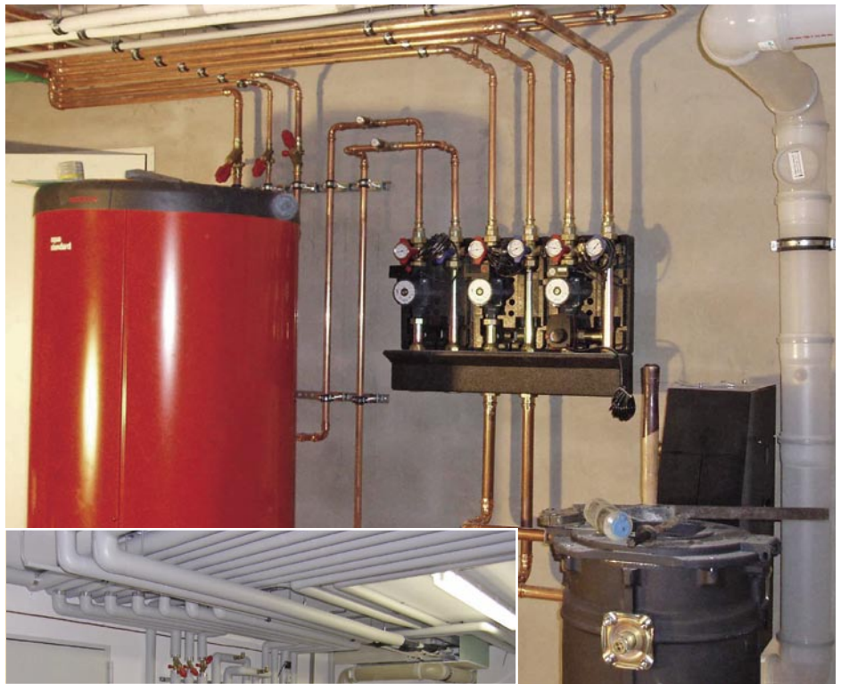
Die Anbindung der Heizungsstränge und des Warmwasserbereiters an den Ölbrennwert Heizkessel erfolgt über vorgefertigte Pumpenbaugruppen
