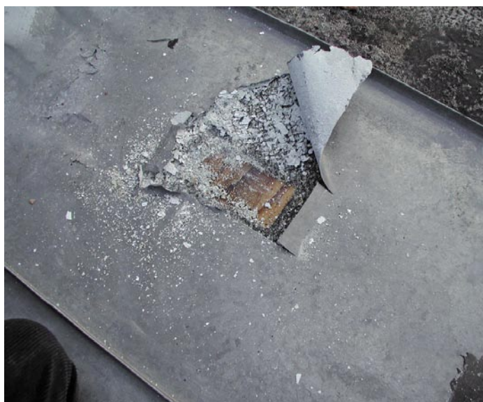
Nach dem Öffnen der oberen Abdeckung werden deutliche Korrosionsschäden sichtbar
