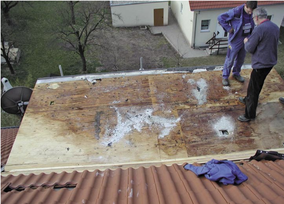
Die unter der Blechabdeckung und Trennlage befindliche Holzplatte ist völlig durchnässt
