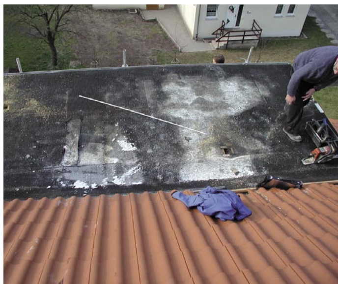
Die Trennlage unterhalb der Titanzinkabdeckung ist stark mit Zink-Rost kontaminiert
