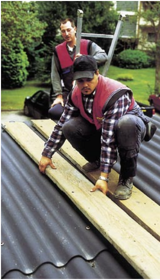
Dächer aus Wellplatten dürfen erst betreten werden, wenn Laufstege angebracht wurden
