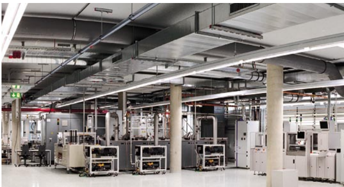
Blick in die PV-TEC Laborhalle des Fraunhofer ISE
