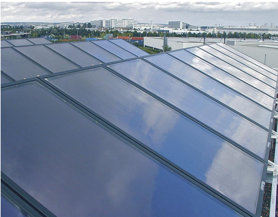
Bild 6 Auf dem Dach des neuen Service Centers GVZ wurden 140 Kollektoren mit einer Gesamtfläche von 280 m 2 für eine optimale Energiegewinnung auf dem Flachdach aufgeständert
