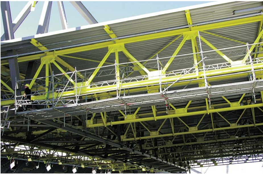
Bild 3 Die Entwässerung der Stadionsdächer erfolgt über innenliegende Rinnen mit untergebauten Druckentwässerungssystemen
