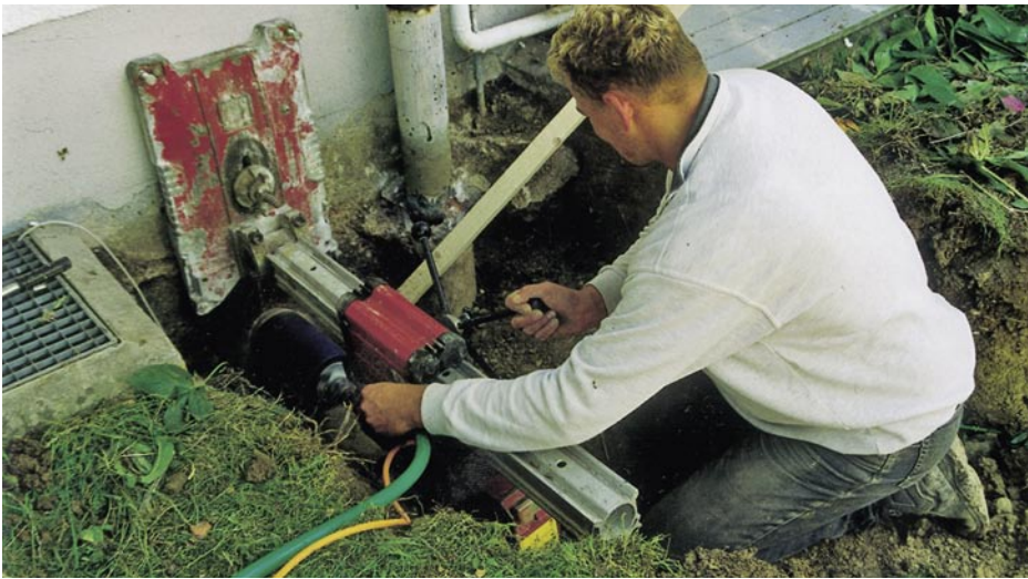
Außenwanddurchführung bei Modernisierung, Kernbohrung für Regenwasser- und Elektroleitung. Dichtungseinsatz wird als Teil der kompletten Anlagentechnik mitgeliefert
