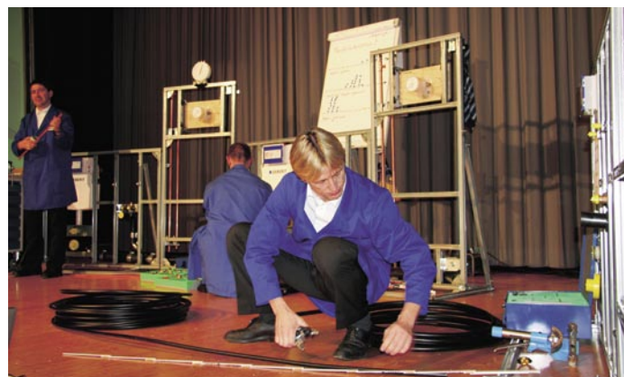
Robert Geiger (vorne) benötigte für die Verrohrung der Montagewand mit dem Mepla-Presssystem 20 Minuten, während seine Kontrahenten mit den Kupfersystemen fast die doppelte, bzw. dreifache Zeit brauchten
