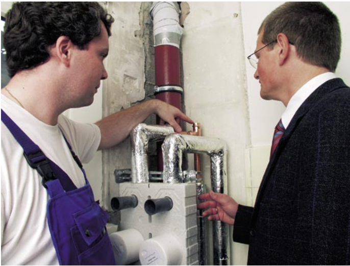
Philip Heyerhoff und Volker Hahn inspizieren das am obersten Punkt des Steigstrangs aufgespresste Endverschlussstück der Inliner-Zirkulation. Es lenkt den Warmwasservorlauf um in das eingezogene Inlinerrohr
