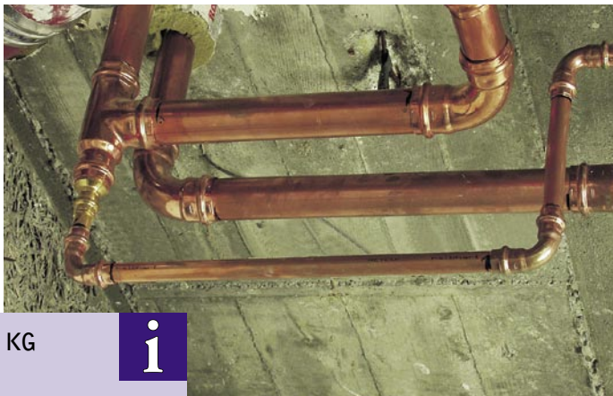
Am Anschlussstutzen der Profipress-Steigleitung im Keller tritt der kleiner dimensionierte Inliner als Rücklauf aus
