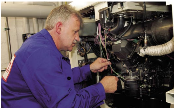
Etwa nach 4000 Betriebsstunden ist bei einem gasbetriebenen Mini-BHKW die Wartung fällig. Da keine motorenspezifischen Arbeiten anfallen, ist die Wartung nach einer Hersteller-Schulung vom SHK-Fachhandwerker durchführbar
