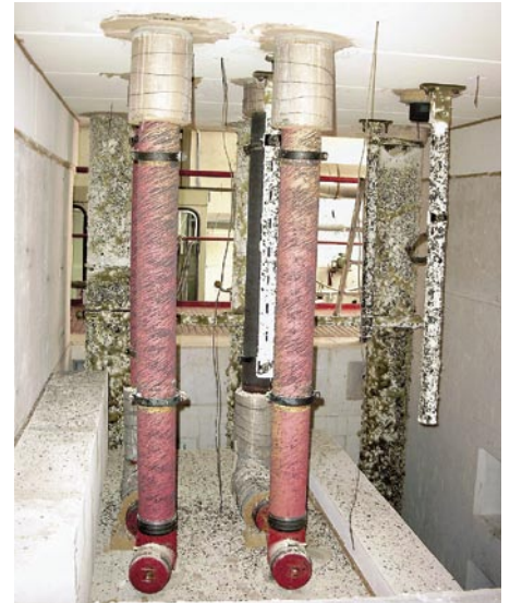
Bild 7: Die Rohre blieben nach dem Brandversuch unbeschädigt
