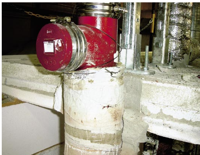
Bild 9: Deutlich sichtbar – Rohre und Isolierungen haben dem Feuer über 90 Minuten standgehalten
