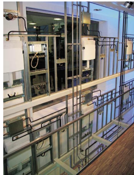
Der Trinkwasserturm in Langenfeld ermöglicht eine gesamtheitliche Betrachtung der Hausinstallation und ist das Pendant zum Abwasserturm in Pfullendorf
