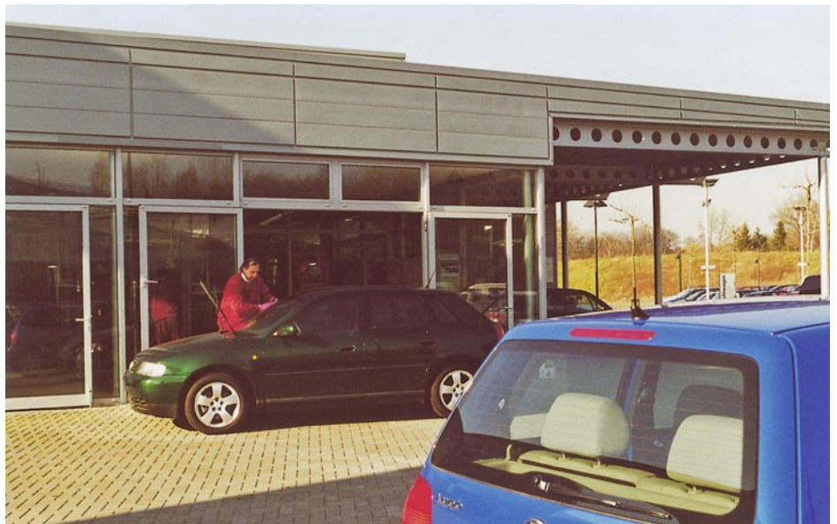
Selbst im Übergangsbereich Fassade/Attika wurde das konstruktive Prinzip der Bekleidung mit gleichmäßigen Fugen beibehalten
