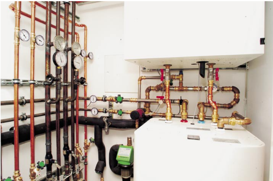
Sowohl Heizungs- als auch Trinkwasserinstallationen wurden in „kalter“ Pressverbindungstechnik ausgeführt
