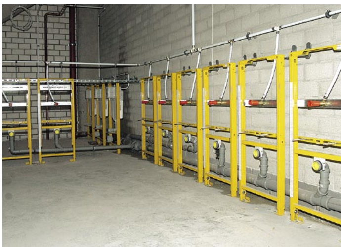
Die Sanitäräume sind mit Grohe-Vorwandinstallationselementen und dem Mehrschichtverbundrohr Alpex-Duo der Fränkischen Rohrwerke ausgestattet
