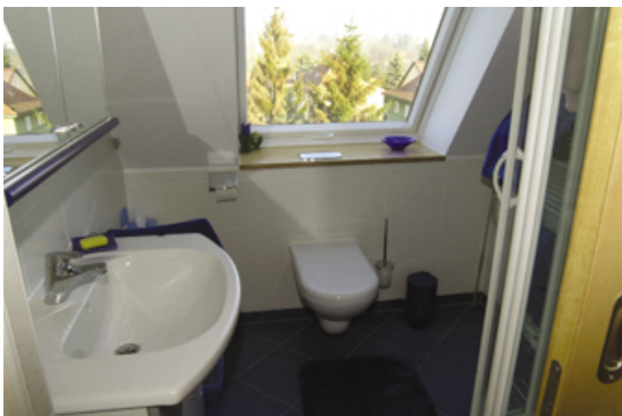
Im Dachgeschoss-Bad ist das WC-Universalmodul in eine Vorwand aus Teceprofil integriert
