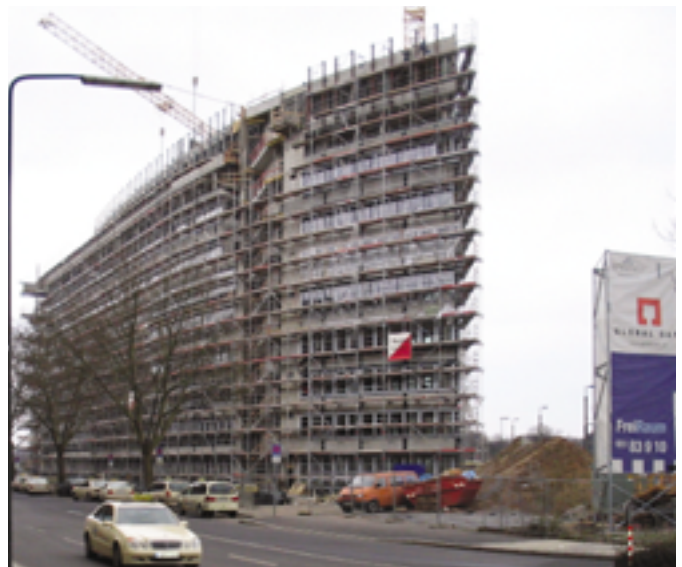
Büroprojekt Global Gate (Abschnitt 3), mit 10 600 m 2 Bürofläche: Mit Zentraleinheit und einer Kombination von Wärmetauscher und Heizradiator werden die Räume ganzjährig klimatisiert
