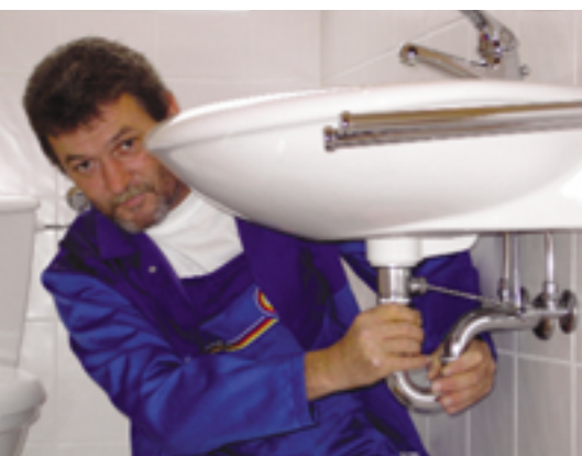
Reparatur- und Wartungsleistungen an Bauwerken gelten bis zu einem Netto-Entgelt von bis zu 500 Euro nicht als Bauleistung
