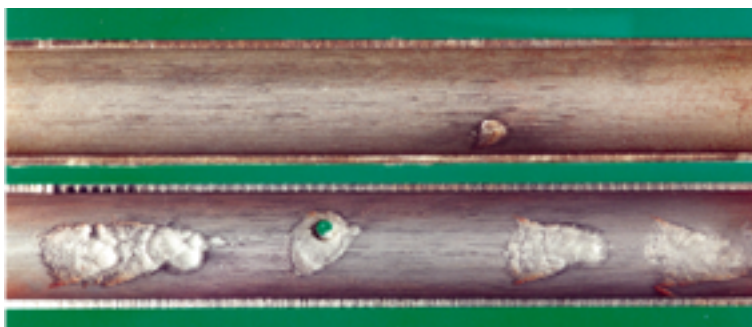
Korrosion an einer Trinkwasserleitung mit Durchbrüchen, Korrosionsprodukte abgebeizt
