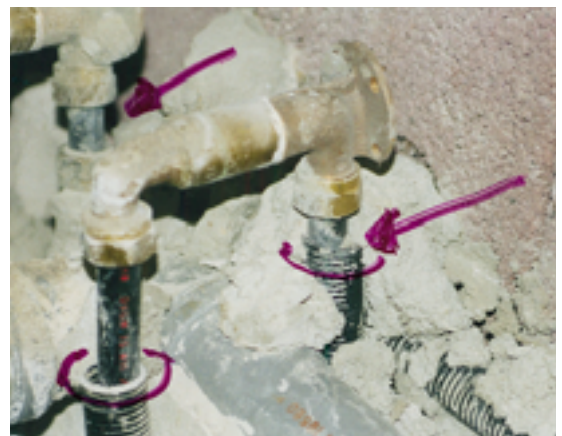
Die PEX-Rohrsystem-Verbindungen sind nicht nachisoliert und die Wandscheiben ohne erforderliche Schalldämmung eingebaut. Auch die Abwasserleitungen wurden ohne Isolierung eingeputzt
