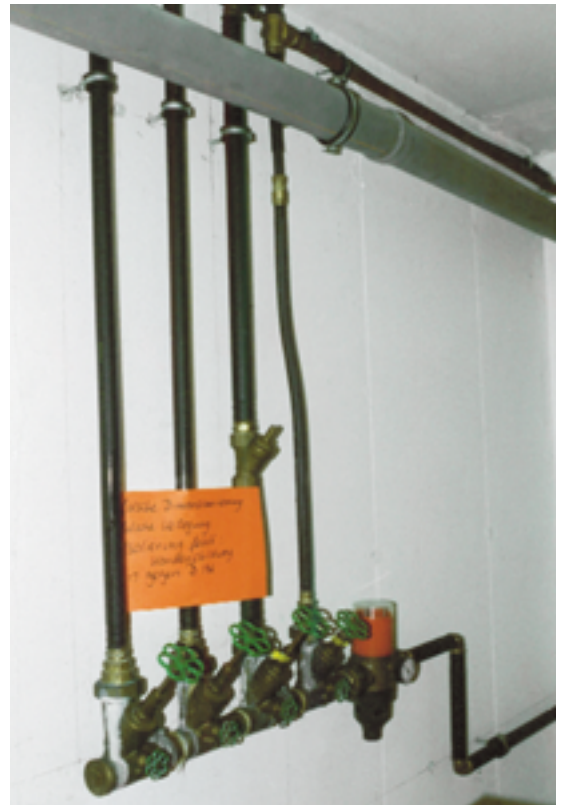
Über diesen Verteiler werden 10 Wohnungen mit Kaltwasser und 18 Wohneinheiten mit Warmwasser versorgt. Sobald in zwei Wohnungen gleichzeitig Wasser entnommen wird, bricht der Druck zusammen. Die Kunststoffrohre sind ohne Brandschutzmanschette durch Wände und Decken geführt und kommen mit Zement in Berührung. Der gesamte Verteiler und die Abgänge sind nicht isoliert
