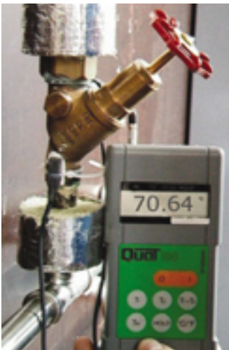
Bild 19 Messung der Rohroberflächentemperatur
