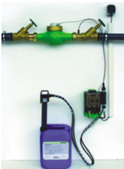
Bild 17 Eingabe des Desinfektionsmittels über Kontaktwasserzähler, Dosierpumpe und Impfstelle
