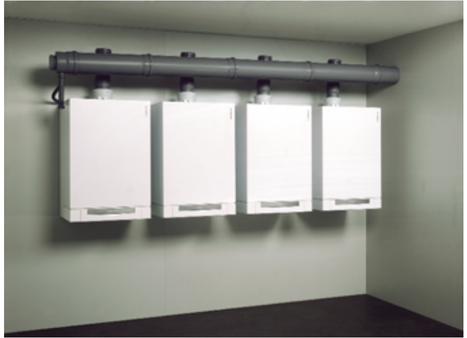
Bild 1 Zentrale Wärmeversorgung eines Mehrfamilienhaus mit Wandgerätekaskade
