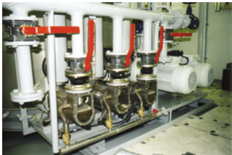
Vier solcher Vakuum-Anlagen sorgen an Bord der Jewel für den Unterdruck im Schwarzwasser-Entwässerungssystem
