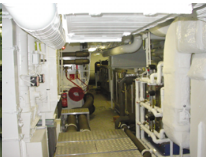
Einer von 31 Klimäräumen an Bord. Stündlich werden hier bis zu drei Millionen Kubikmeter Luft durchgesetzt ...
