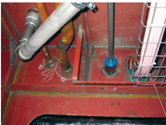
Im Schiffrohrbau gilt: Egal ob Rohr oder Kabel, Durchführungen ohne Brandabschottungen gibt es nicht
