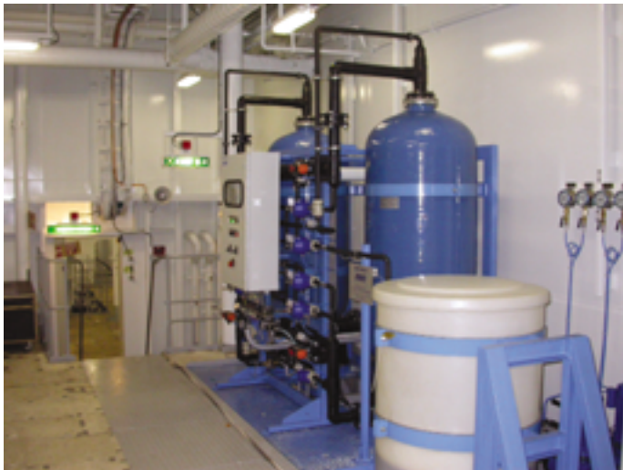
Das Trinkwasser wird über zwei Verdampfer und dieser Umkehrosmoseanlage hergestellt
