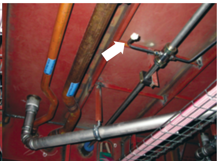
Mit 160 bar Wasserdruck ersticken die Düsen (Pfeil) der Hochdruck-Nebelanlagen auf den technischen Decks jedes Feuer im Keim
