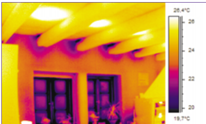
Beim Blower-Door-Test fallen mangelhaft abgedichtete Ecken sofort auf, weil kalte Luft von außen eindringt
