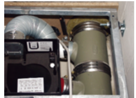
Die Verbindung der Rohre und Formstücke erfolgte mit den aus der Entwässerungstechnik bekannten Rapid-Verbindern
