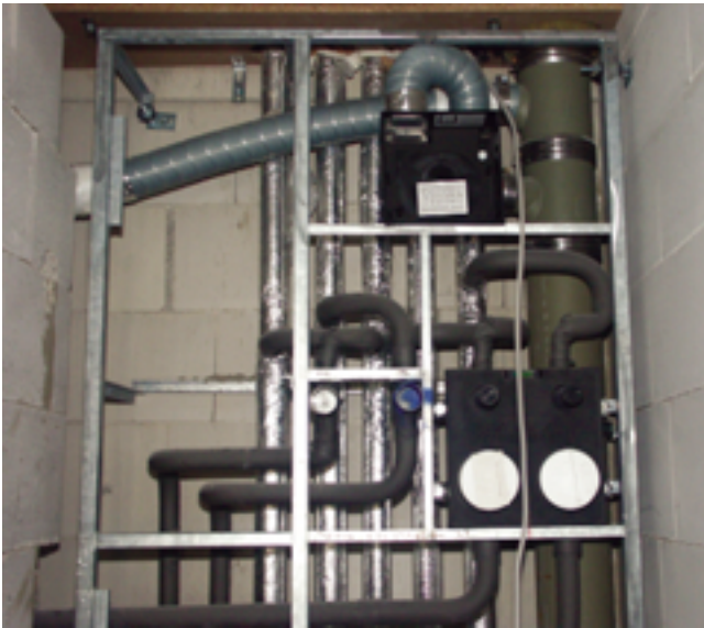
Übereinander liegende Bäder und WC-Anlagen sind an eine gemeinsame Lüftungsleitung angeschlossen
