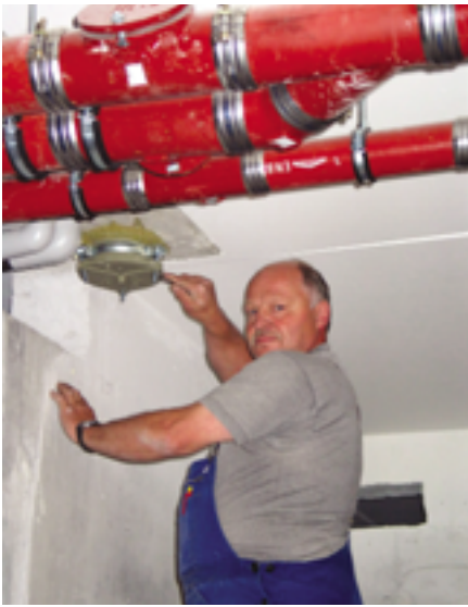
Obermonteur Hans Eder: „Für Raumentlüftung und Gebäudeentwässerung haben wir insgesamt 3000 m muffenloses Gussrohr verlegt“
