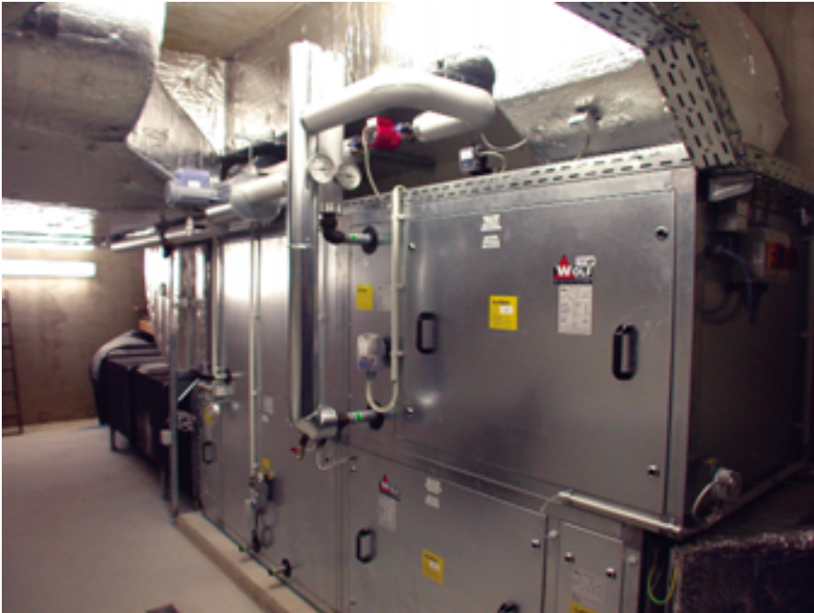
Lüftungszentrale mit Nennluftvolumen 5 000 m 3 /h; ein Erdkanal erlaubt die Vorkühlung/ Vorwärmung der Zuluft um ca. 5 K
