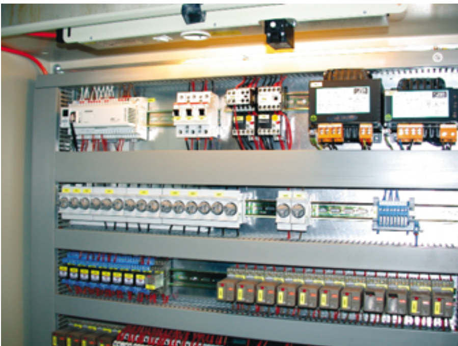
Schaltschrank mit Synco-Regelbausteinen
