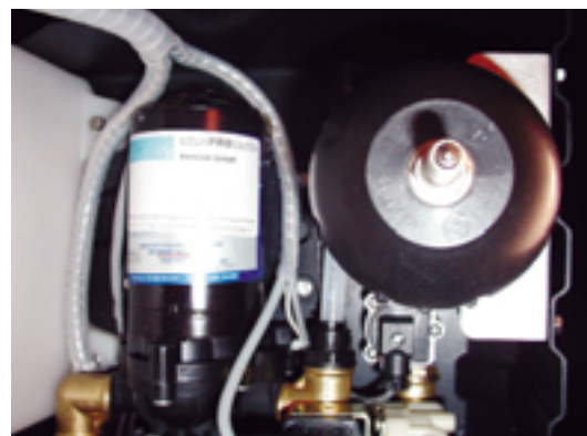
Zahnarzt-Behandlungsstühle ohne DVGW-Zeichen müssen über freien Auslauf und Pumpe versorgt werden, die in einer anschlussfertigen Einheit zusammengefasst sind
