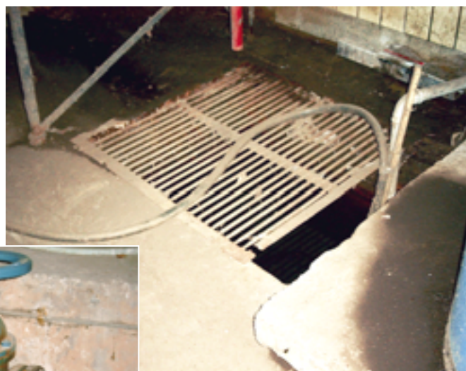
... der dann direkt in einen Abwasser-Sammelschacht hineinführt
