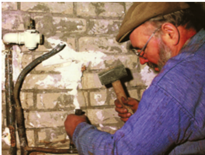
Bleirohre sollten aus der Trinkwasserinstallation so schnell wie möglich entfernt werden
