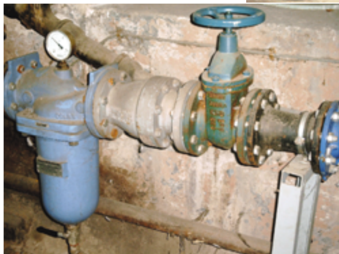
Lecker: An diesem Rückspülfilter wurde zur Ableitung des Spülwassers ein Schlauch an den Spülhahn angeschlossen ...
