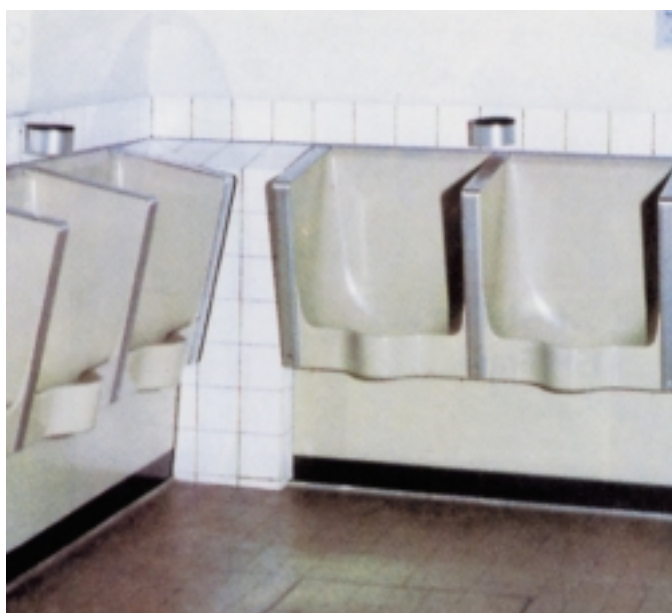
Bild 2 Reihen-Wandurinalanlage ohne Wasserspülung aus glasfaserverstärktem Polyester
