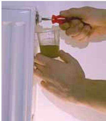
Bild 6 Über Geruch und Farbe läßt sich selten die Qualität des Heizungswassers erkennen
