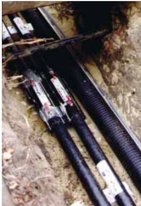
Bild 1 Konkurrierende Systeme im gemeinsamen Graben: nachisolierte Stahlrohrleitung neben Ecoflex-Rohr
