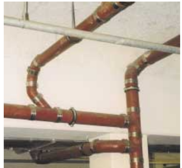
Bild 1 Verschlanken wird sich das Bild unter der Kellerdecke: Die neue Berechnung führt zu kleineren Nennweiten
