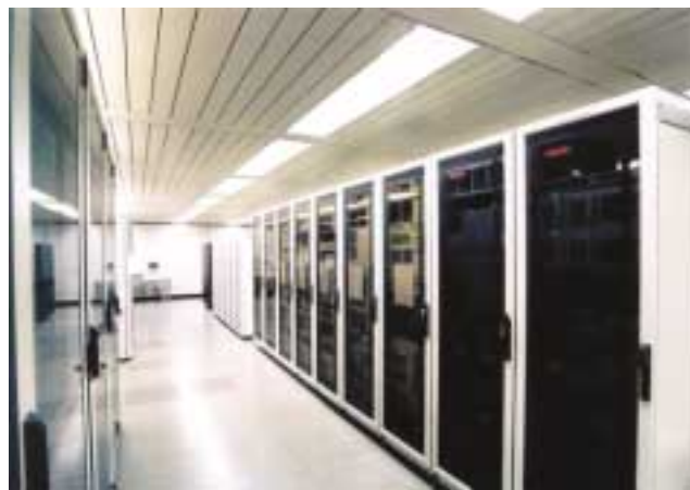
Bild 1 Serverräume stellen einen typischen Anwendungsfall für OxyReduct dar
