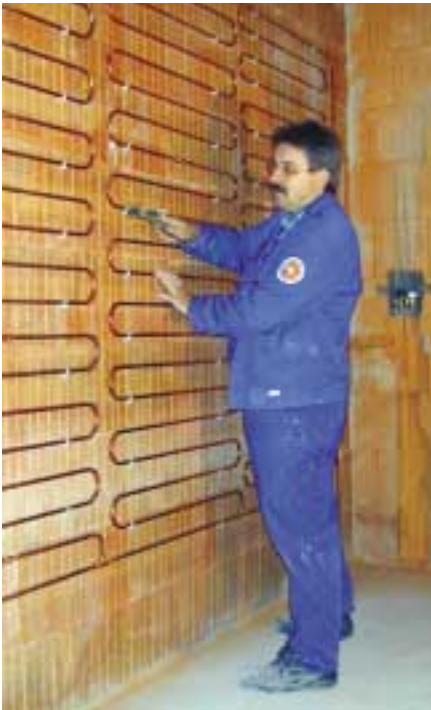
In verschiedenen Büroräumen wurde eine „Hypoplan“-Wandheizung installiert
