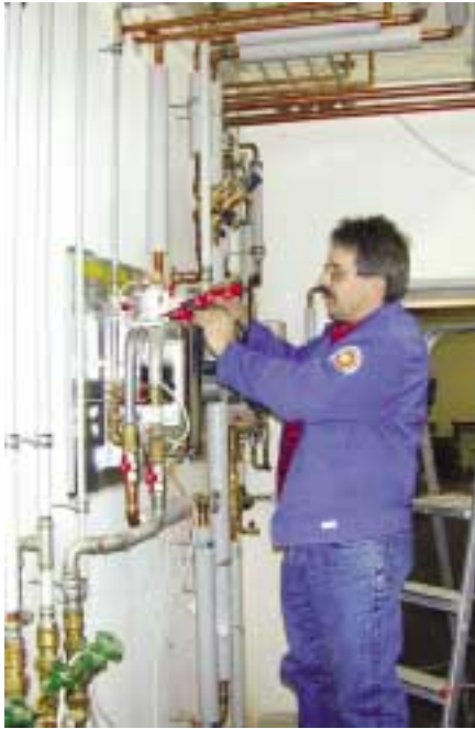
Die Rohrinstallation wurde in „Copatin“, „Wicu_extra“ und „Wicu“ ausgeführt
