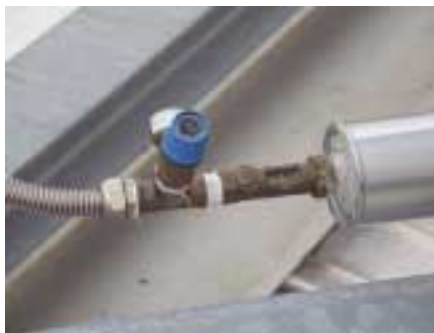
Problematisch: Teflon, direktdurchflossener Durchflußmesser und Standard-Sicherheitsventil in unmittelbarer Nähe des Kollektors
