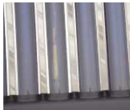
Verfärbung durch Überhitzung am Absorber eines Röhrenkollektors
