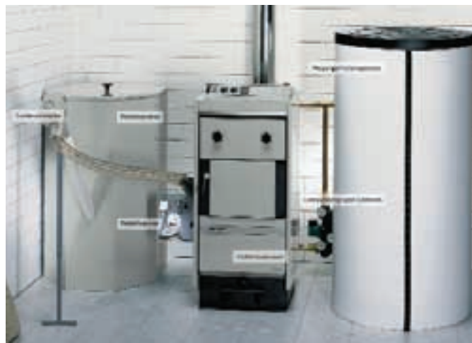
Pellet-Kesselanlage mit Pellet-Vorratsbehälter und Förderschnecke (l.) sowie Heizwasserpufferspeicher (Sieger)
