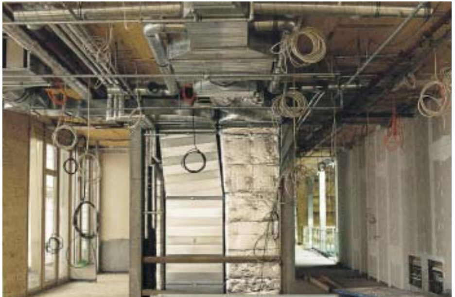
Wärmeluftkonvektoren, Kühlsegel, Fußbodenheizung – die Nordrhein-Westfälische Dependance wird mit den unterschiedlichsten Systemen temperiert und klimatisiert
