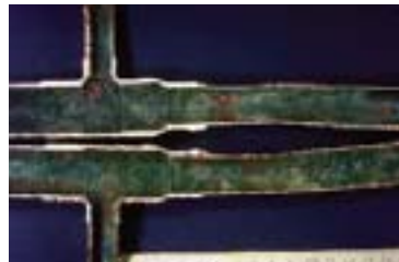
Bild 1 Lochfraß bei einem gelöteten Kupferrohr
