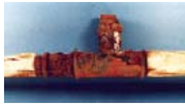
Bild 4 In einem Bodenkanal verlegtes Heizungsrohr, dessen Verbindung nicht korrosionsschutzgeführt wurde
