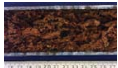
Bild 7 Rohrstück aus verzinktem Stahl, dessen Betrieb außerhalb der zulässigen Spezifikation (Wasserbeschaffenheit) lag
