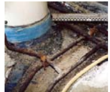
Bild 5 Der Fußboden mußte zerstört werden um an die undichten Rohrleitungen zu gelangen
