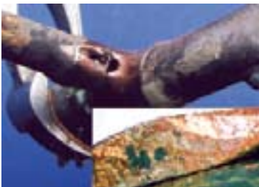
Bild 3 Rißbruch an T-Stück durch nicht berücksichtigte temperaturbedingte Längenänderung
