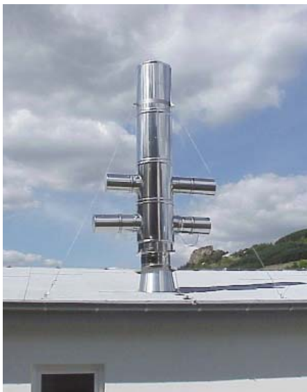
Anlagenspezifisches Beispiel mit kombinierten aktiven und passiven Abgasschalldämpfern. Aus Platzgründen mußten die – aufgrund von Geräuschproblemen in der Umgebung – nachträglich eingebauten Schalldämpfer im Freien angeordnet werden
