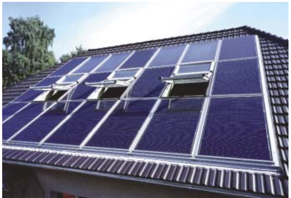
Integrierte Solaranlagen sind architektonisch und ästhetisch ansprechend (Schüco)
