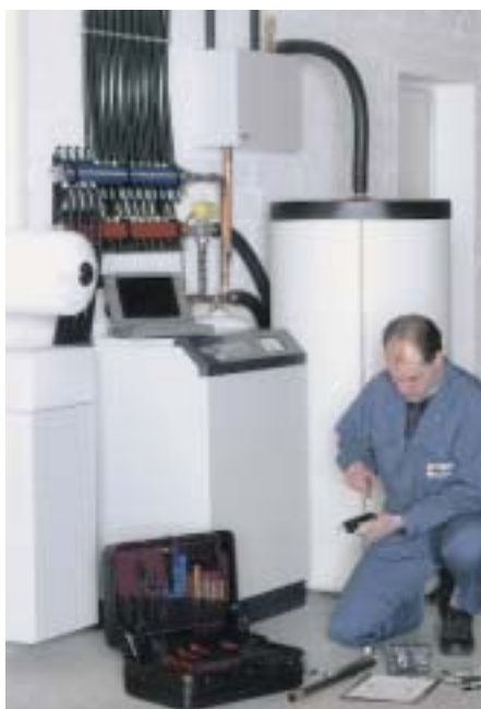
Dem Heizungsbauer soll mit der Wärmepumpe ein Zusatzgeschäft winken
