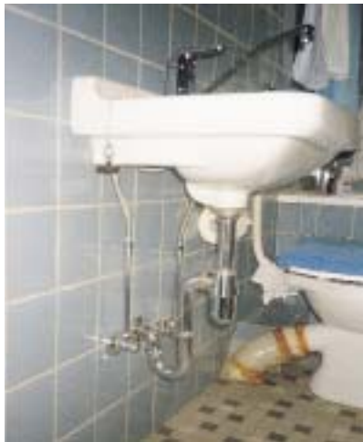
Verlegenheitslösung: Höhenausgleich mit Doppelsicherung
