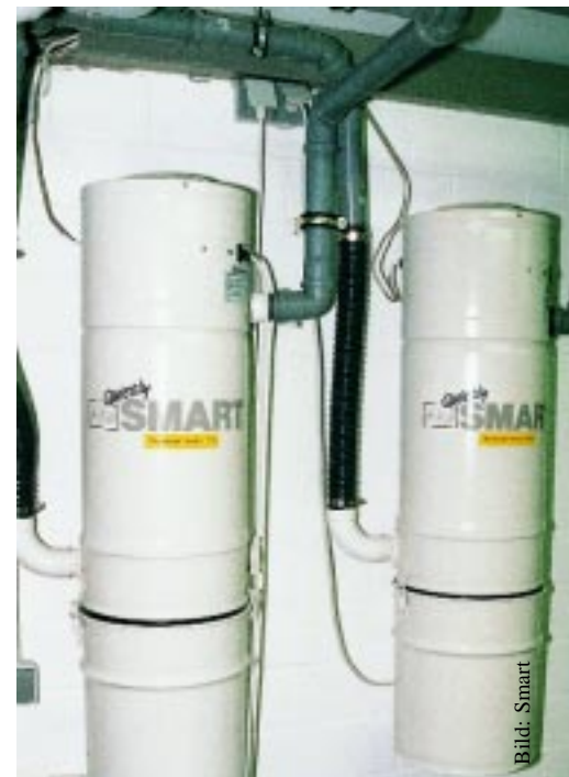
Um Mikrostäube wie Pilzsporen aus dem Wohnbereich ins Freie zu befördern und nicht nur in den Räumen herumzuwirbeln, sollten zentrale Staubsauganlagen installiert werden
